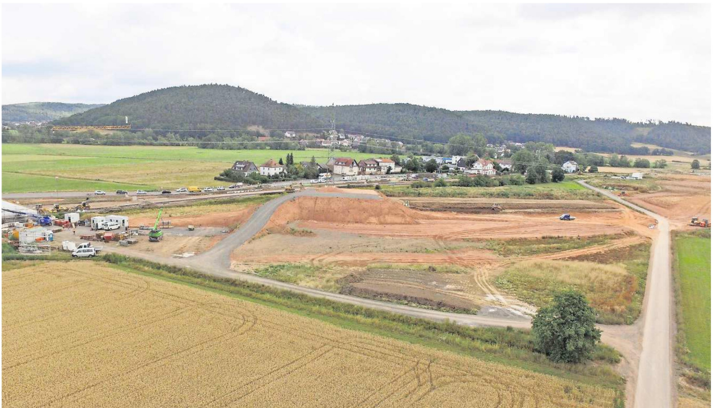
So sah es gestern rund um die Baustelle bei Sarnau aus, wo die Verlegung der Gleise in vollem Gange ist.
